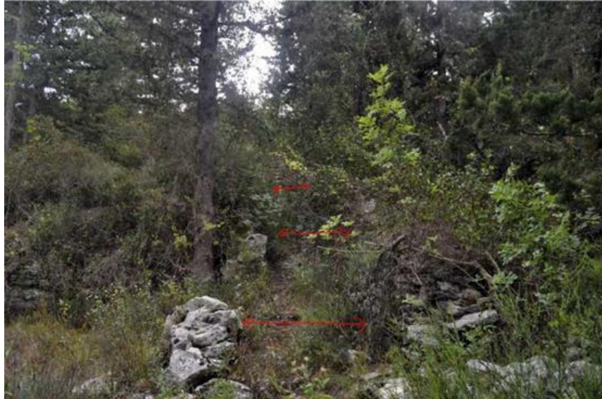
Εικόνα 32: ενδεικτικός καθαρισμός από θλάστηση «V2»
