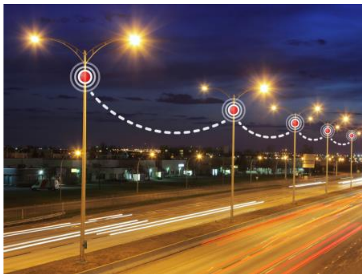
Εικόνα 7.16: Σύστημα διαχείρισης ηλεκτροφωτισμού με LEDs.
