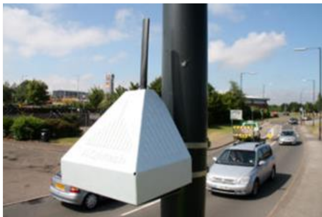
Εικόνα 7.9: Εγκατεστημένος πολυαισθητήρας παράλληλα με το δίκτυο ηλεκτροφωτισμού
